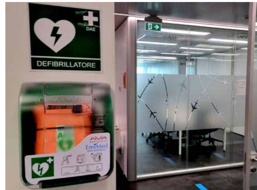
Il defibrillatore installato negli uffici NPU2 di FCO
