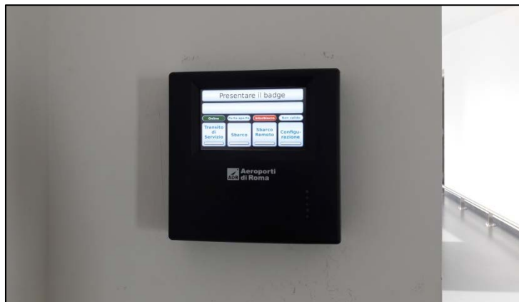
Display da cui si gestisce l'apertura delle porte all'interno del torrino
