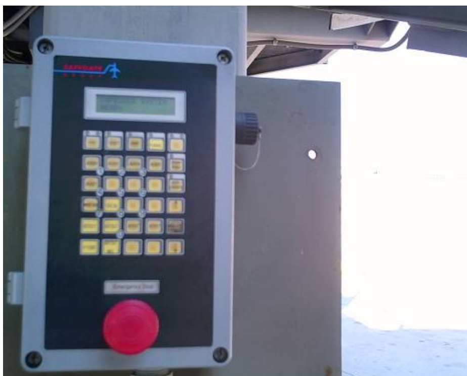
Foto n. 2 – Pontili Parcheggio quadrante 800 (ex Kilo) – Guida ottica : Pannello operatore
