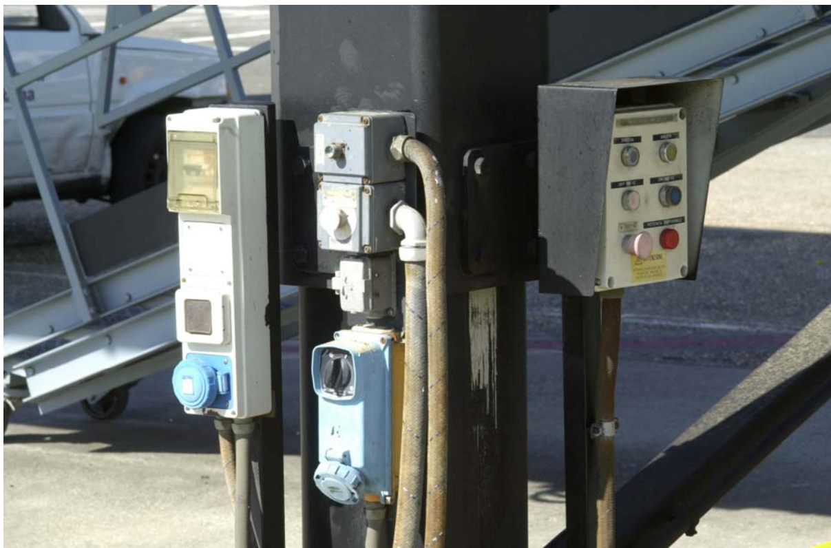
Foto n. 3 – Pontili Parcheggio quadrante 800 (ex Kilo) - Pulsantiera fissa 400Hz
