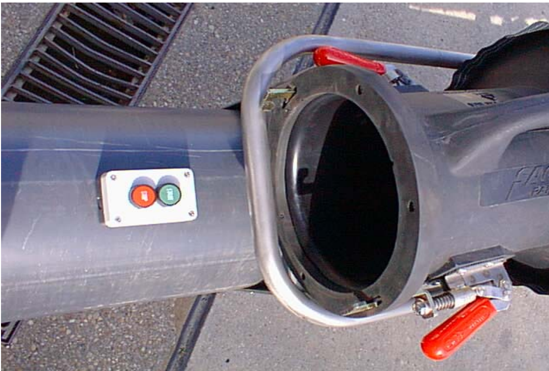
Foto n. 7- Pontili Parcheggio quadrante 800 (ex Kilo) – Impianto aria climatizzata : Particolare tubazione rigida
