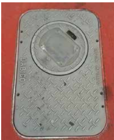
Figura 3 - Pozzetto dell'impianto di climatizzazione
