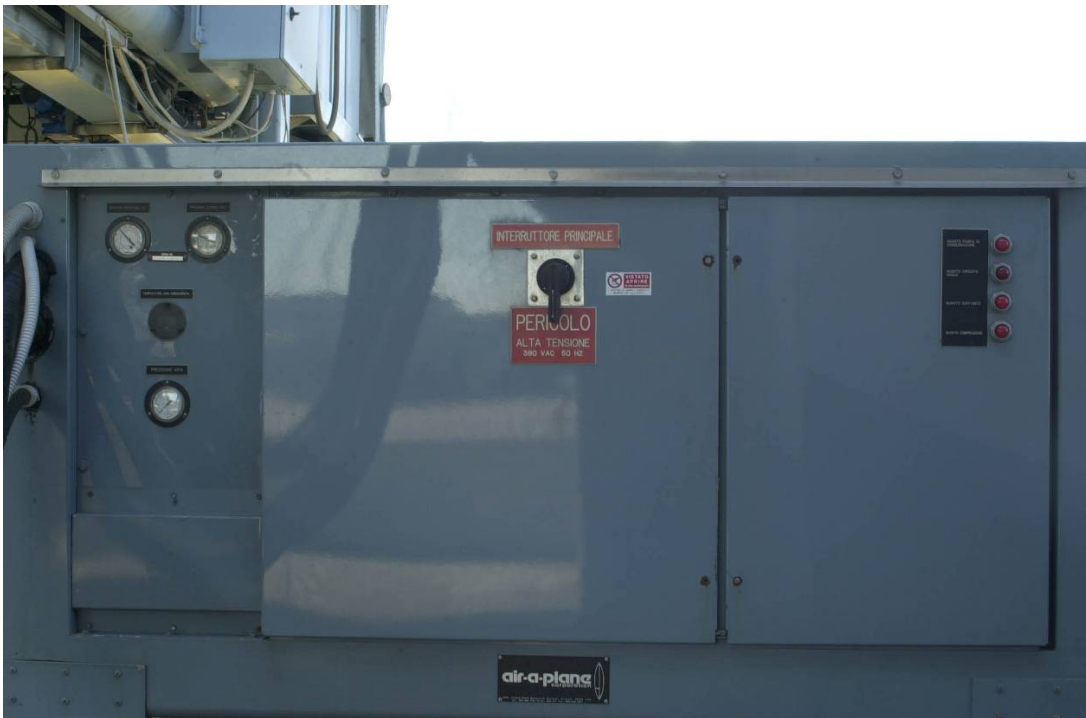
Foto n. 9 – Pontili Parcheggio quadrante 500 (ex Bravo) – Macchina impianto aria climatizzata
