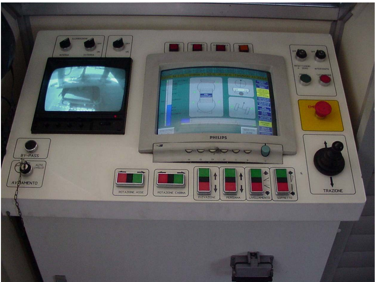
Foto n. 6 – Pontili Parcheggio quadrante 500 (ex Bravo) – Pulpito di comando pontile (Apron Drive)
