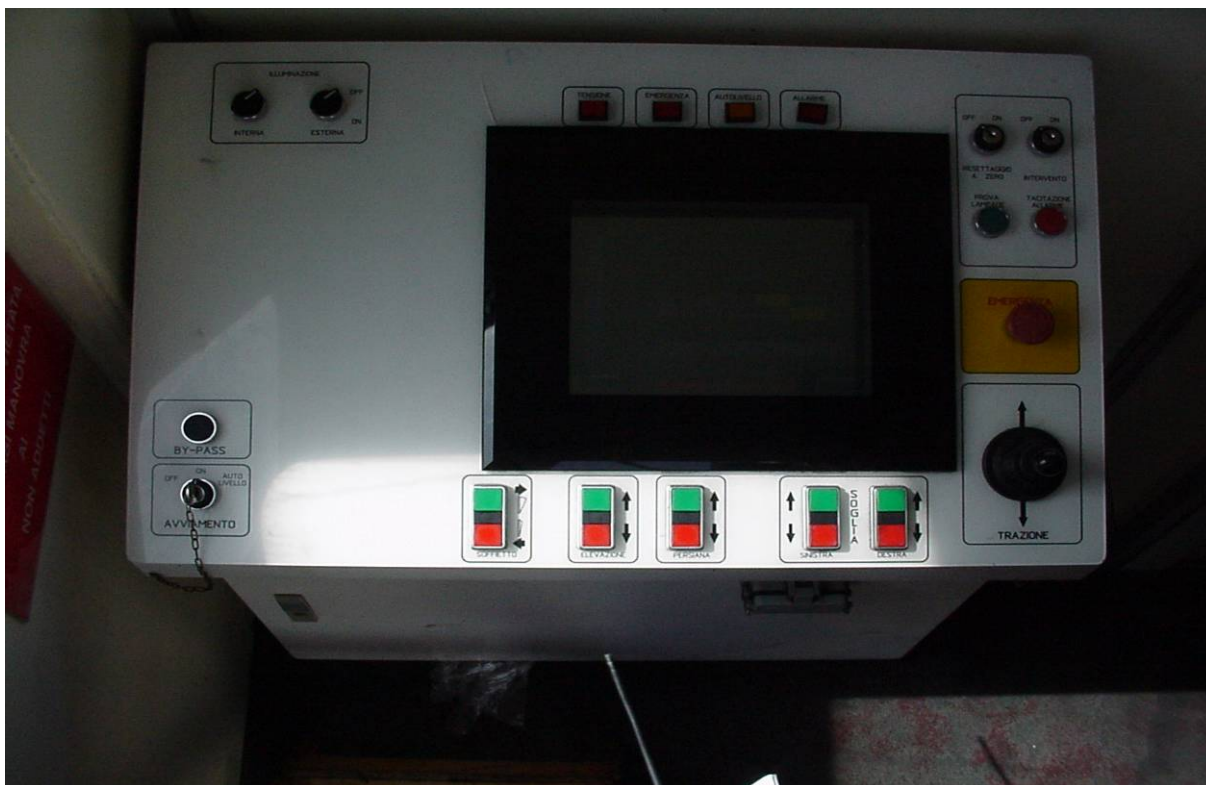
Foto n. 7 – Pontili Parcheggio quadrante 500 (ex Bravo) – Pulpito di comando pontile (Pedestal)
