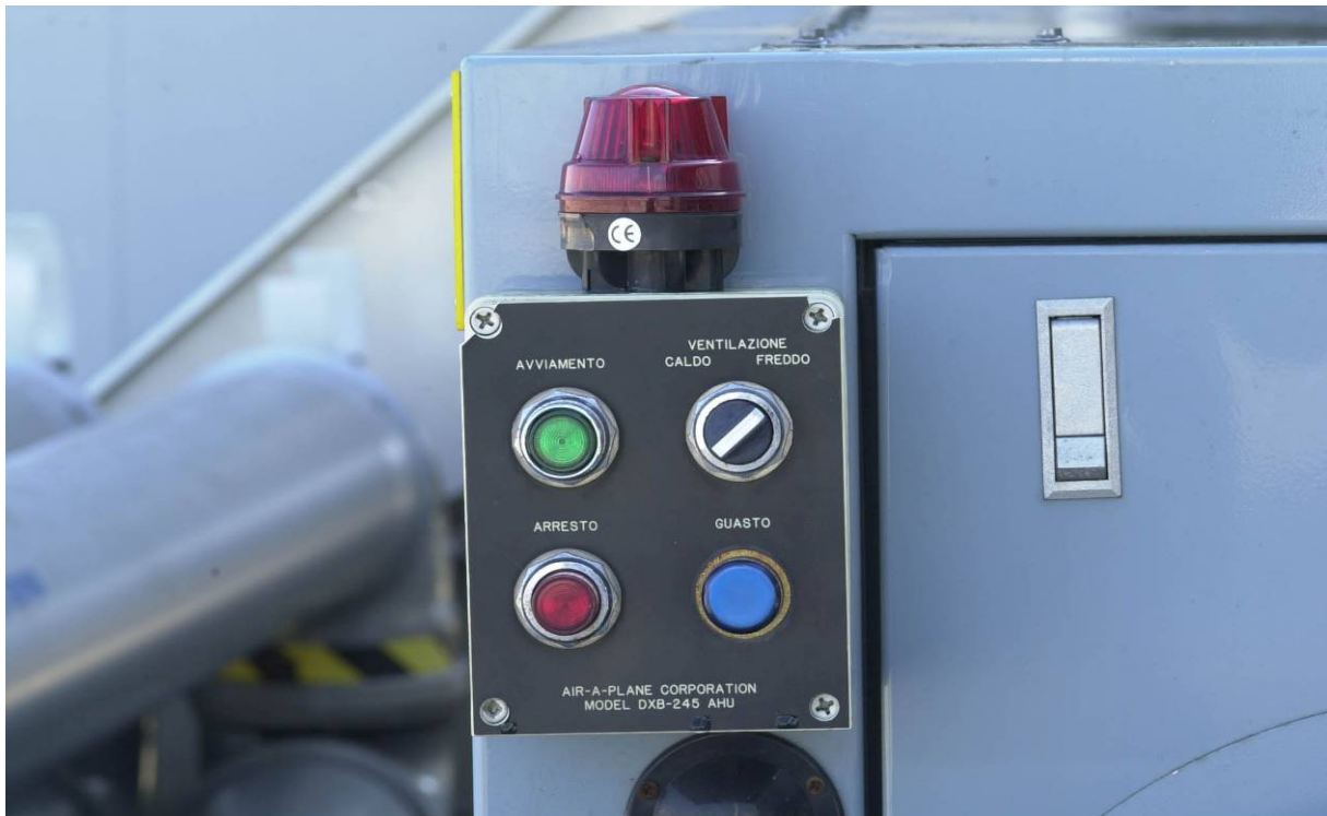
Foto n. 10 – Pontili Parcheggio quadrante 500 (ex Bravo) – Pannello macchina impianto aria climatizzata
