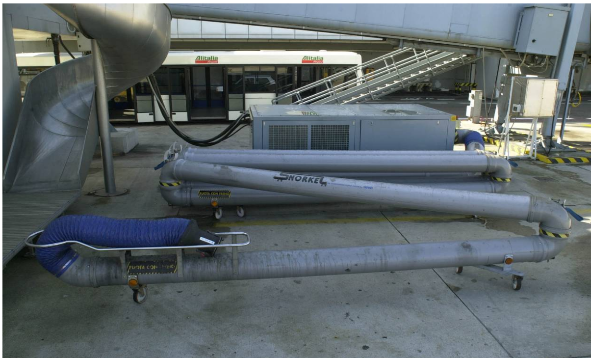
Foto n. 8 – Pontili Parcheggio quadrante 500 (ex Bravo) – Impianto aria climatizzata : Tubazione rigida in PVC
