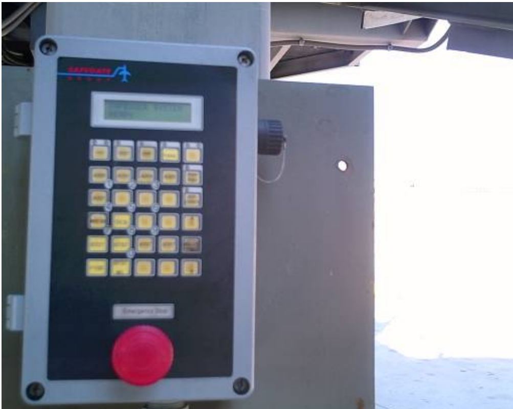
Foto n.2 – Pontili Parcheggio quadrante 500 (ex Bravo) – Guida ottica : pannello operatore
