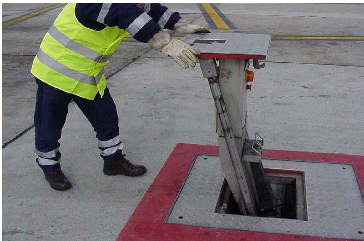
Foto n 6 – Parcheggi remoti 800 (ex Whiskey) – Pozzetto 400Hz inizio manovra di chiusura
