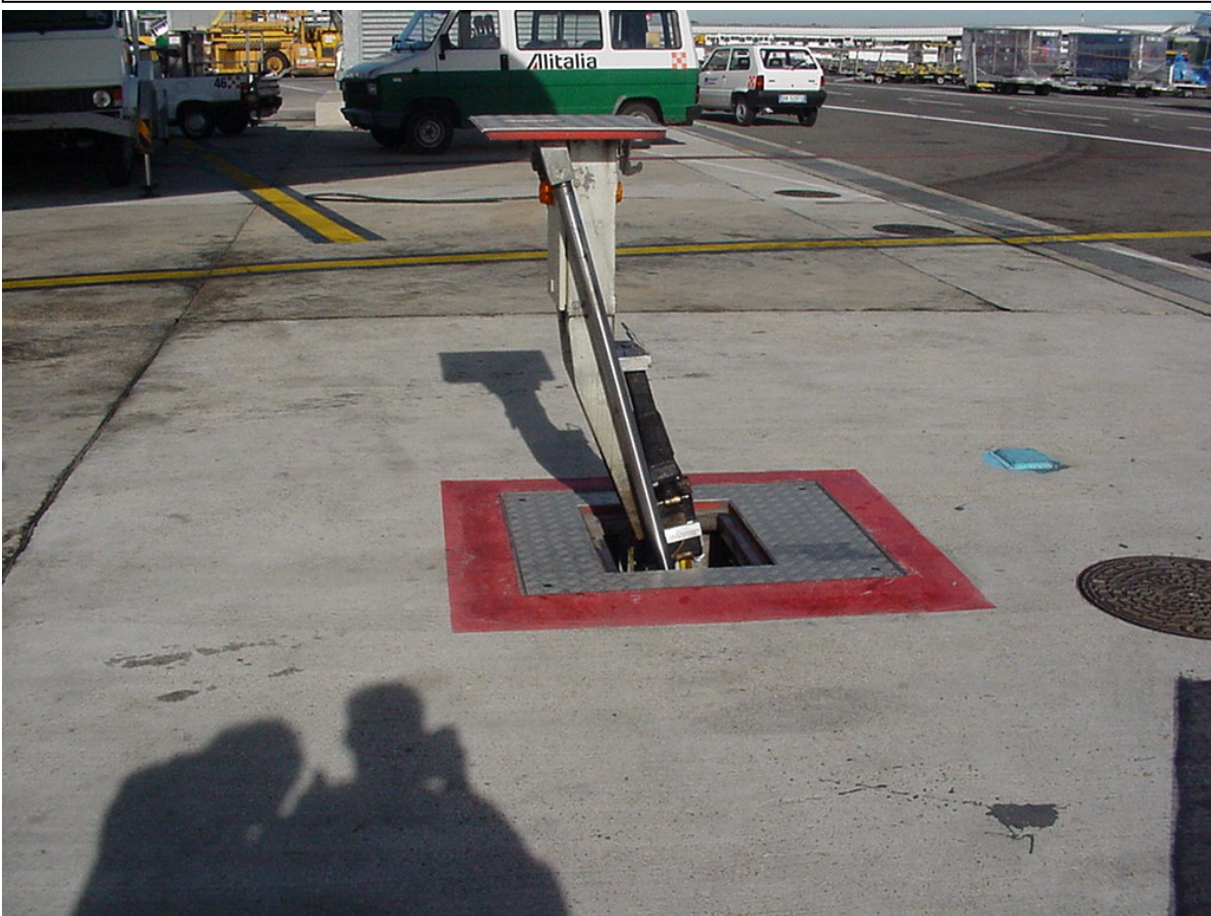
Foto n.2 – Parcheggi remoti 800 (ex Whiskey) - Pozzetto 400Hz con chiusino elevabile
