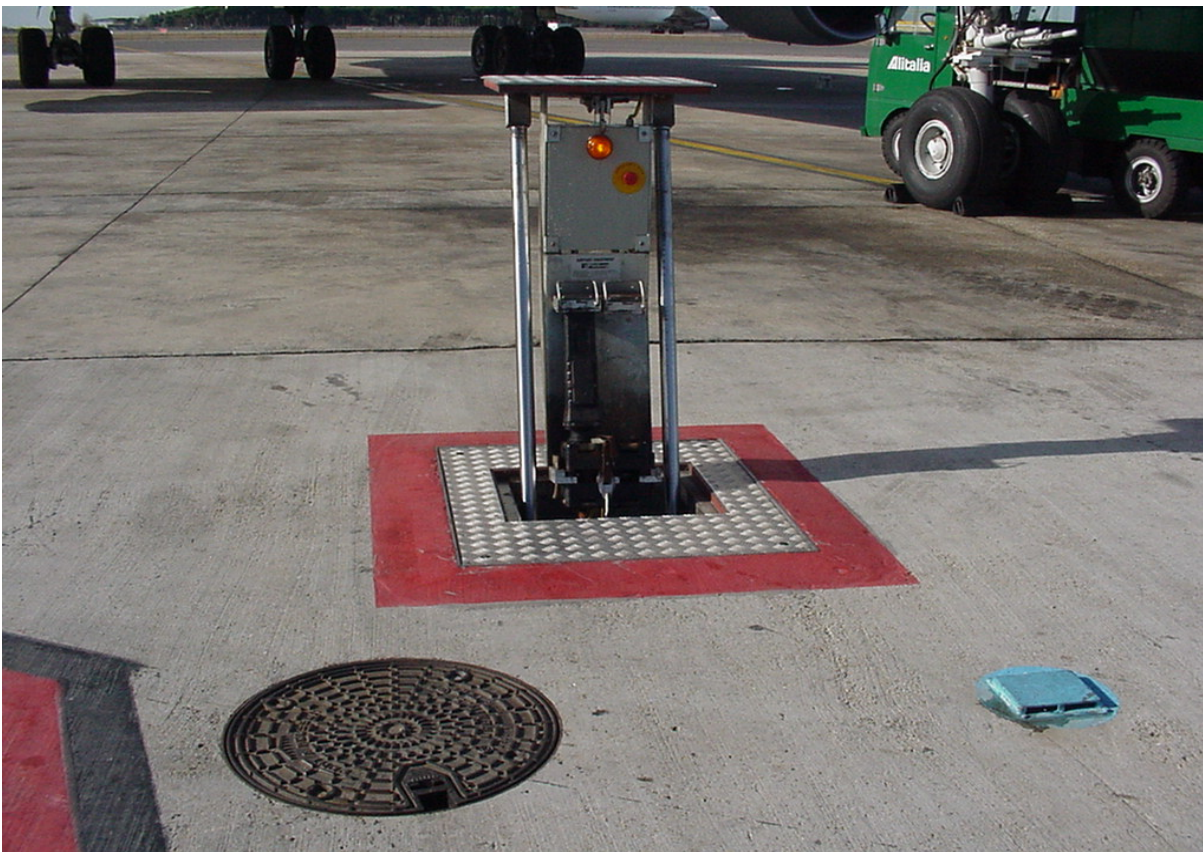
Foto n.3 – Parcheggi remoti 800 (ex Whiskey) – Pozzetto 400Hz con chiusino sollevato e spia gialla di fine corsa accesa - lato interno
