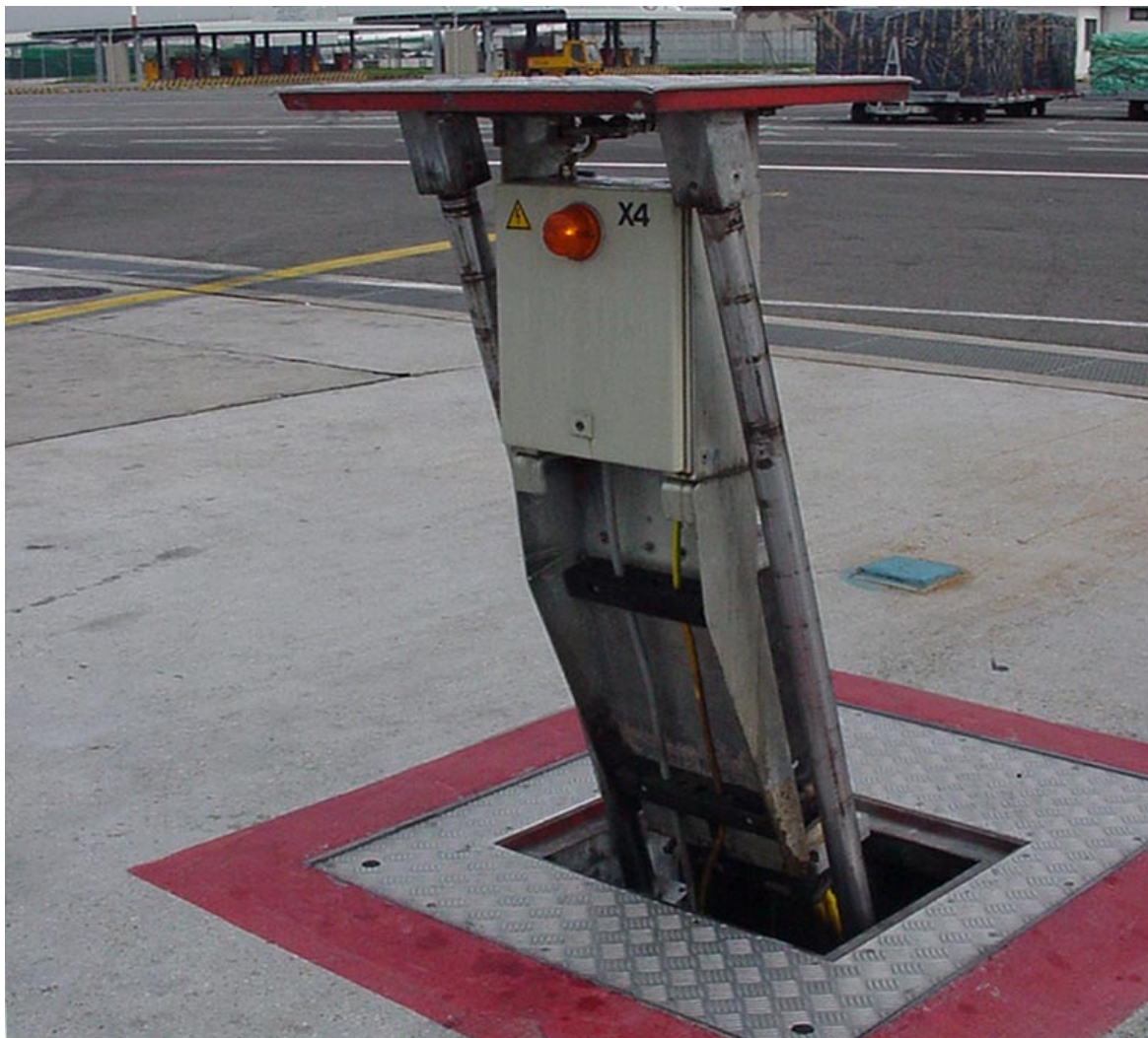
Foto n 5 – Parcheggi remoti 800 (ex Whiskey) – Pozzetto 400Hz con spia gialla di fine corsa - lato esterno
