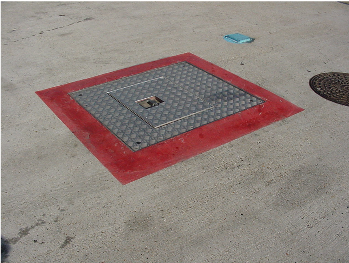
Foto n.1 - Parcheggi remoti 800 (ex Whiskey) - Pozzetto chiuso e bocchetta espulsione acqua impianto 400H
